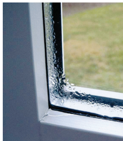
Obr. 4: Nej slabším místem izolačního dvojskla jsou rohové spoje distančního rámečku, v jejichž blízkosti může na okně docházet ke kondenzaci
